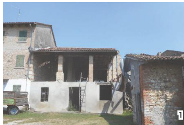
Edificio non funzionale alla conduzione del fondo
