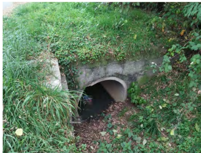
Sforatore di emergenza del Ru Nero in via Antighe
